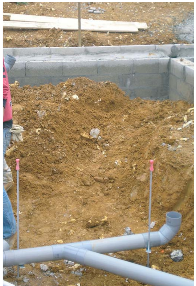
Mise en place des canalisations sur les Firos avant la mise en place de la mousse
